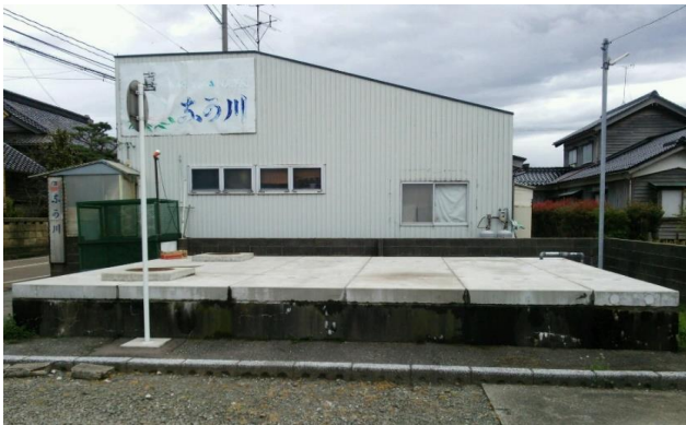
【現場打ち水槽の蓋】
