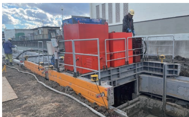
▲シールド機全周プリズム配置状況 全周プリズム
