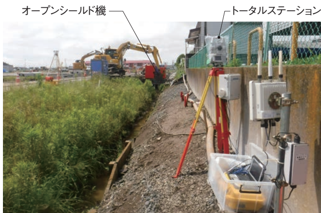
▲自動追尾型トータルステーション、機器類配置状況
