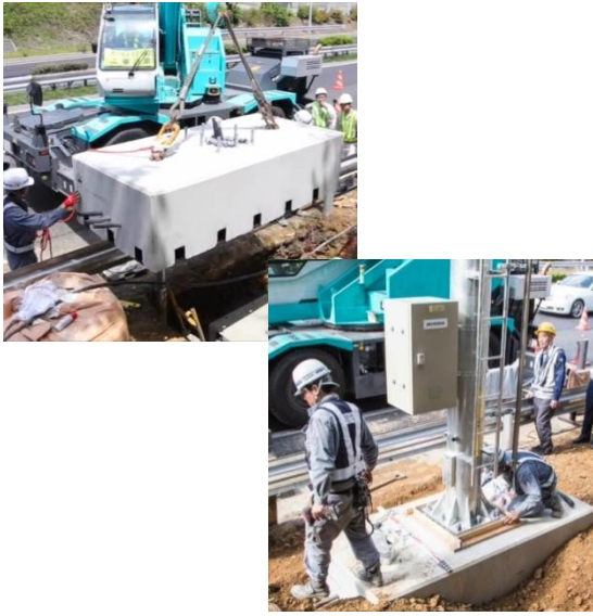
CCTVカメラ支柱ベース
